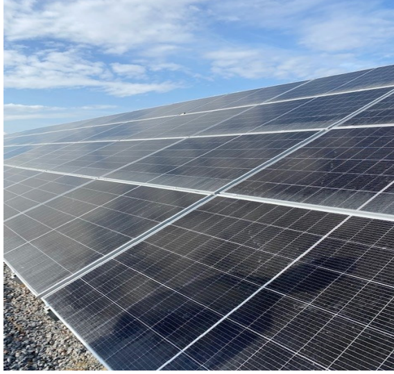
Şekil 2. Arazide Kurulu Güneş Enerji Santrali
