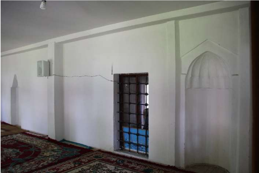
Foto 24. Yakova, Rugova Köyü, Hasan Ağa Camisi, kapalı son cemaat yeri, doğu mekân, güney duvardaki dış mihraplar.
