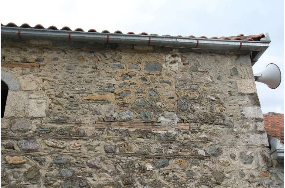
Foto 111. Pojaran Köyü Camisi, doğu cephenin kuzeyinde kapatılmış pencereye ait izler.
