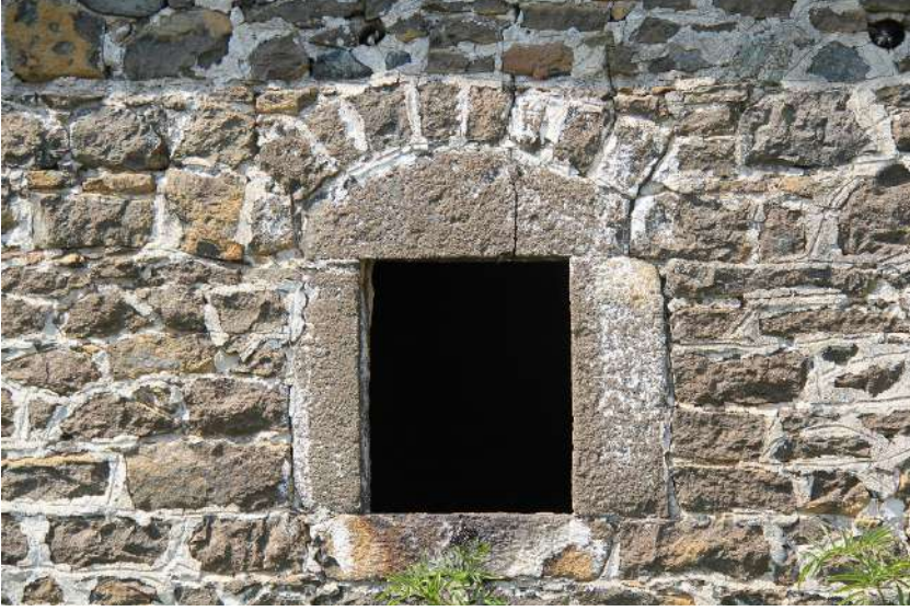
Foto 125. Smoliça Köyü Camisi, güney cephenin batısındaki pencere.
