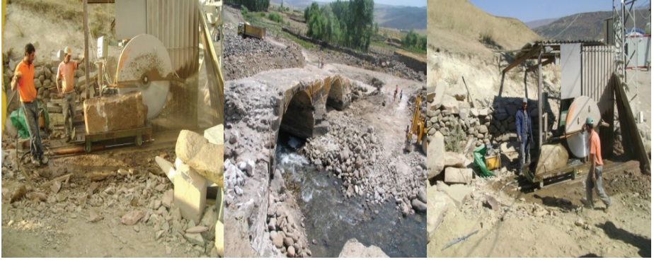
Şekil 18-20. Muş/Varto Kaynarca Köprüsü Onarım Çalışmalarında Andezit Taşının İşleme ve Kullanımı Görünüşleri (Öztürk, 2014).
