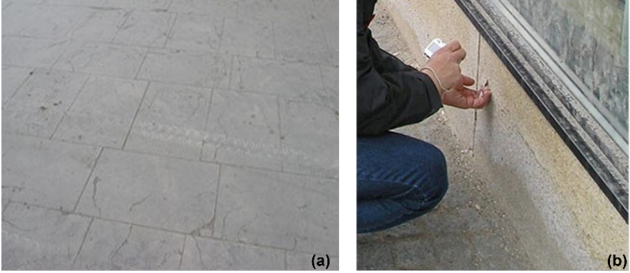
Şekil 6. Zemin Kaplamasında Tipik Donma Hasarı (a) ve Don ve Tuzların Birleşik Etkisi Altında Doğal Taşın Parçalanması (b) (URL 3, 2023)
